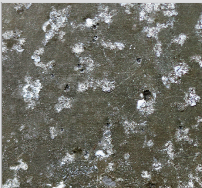
Detalles de la corrosión superficial
